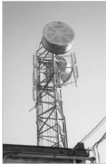
Figure 8. Emplacement d'une station de base avec une liaison par faisceau hertzien
