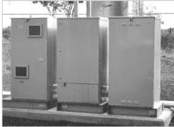
Figure 9. Armoires de matériel électronique d'une station de base
