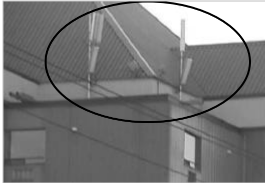
Figure 10. Antennes cellulaires montées sur un bâtiment
